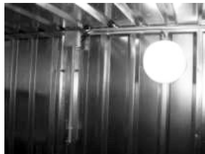
Eclairage éco-énergie avec détecteur de présence
