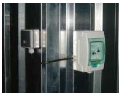
Coffret d'alimentation IP65 (Cas éclairage et/ou ventilation) Inter différentiel 2P-25A-30mA Disjoncteur 10A (par fonction)
